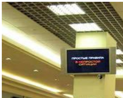
Пункт информирования и оповещения населения в здании с массовым пребыванием людей
